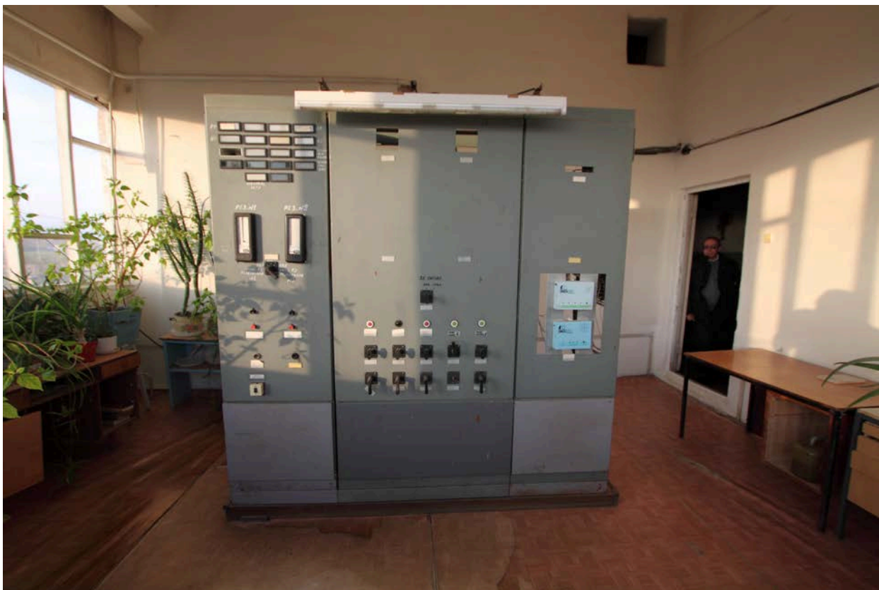
Рис.13 – Диспетчерский пункт водоочистных сооружений
