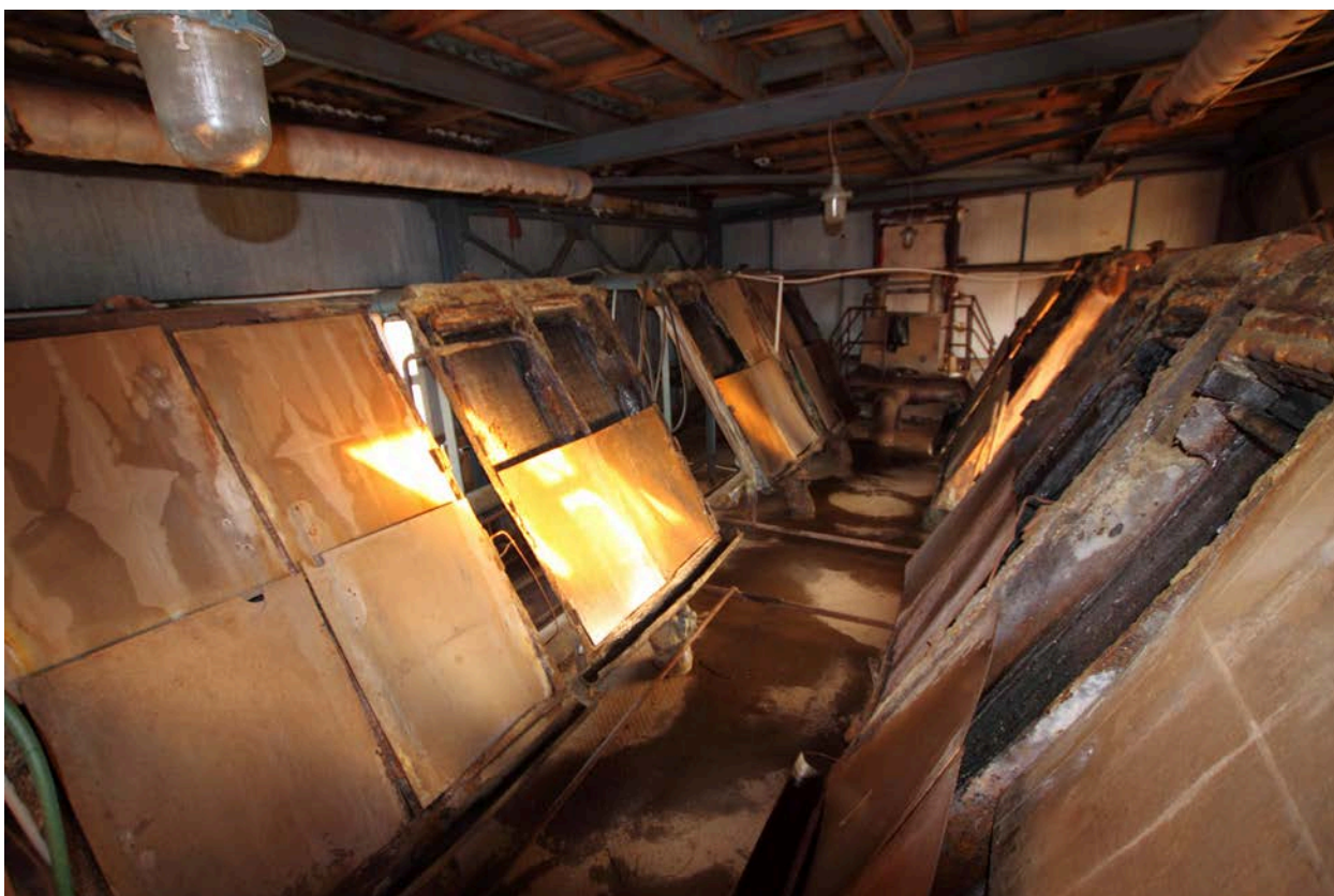
Рис. 20 – Техническое состояние УФС
