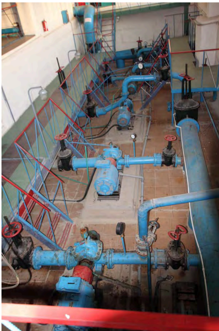
Рис.9 – Насосная станция II подъема (на переднем плане насосы типа Д для нужд водоочистных сооружений)
